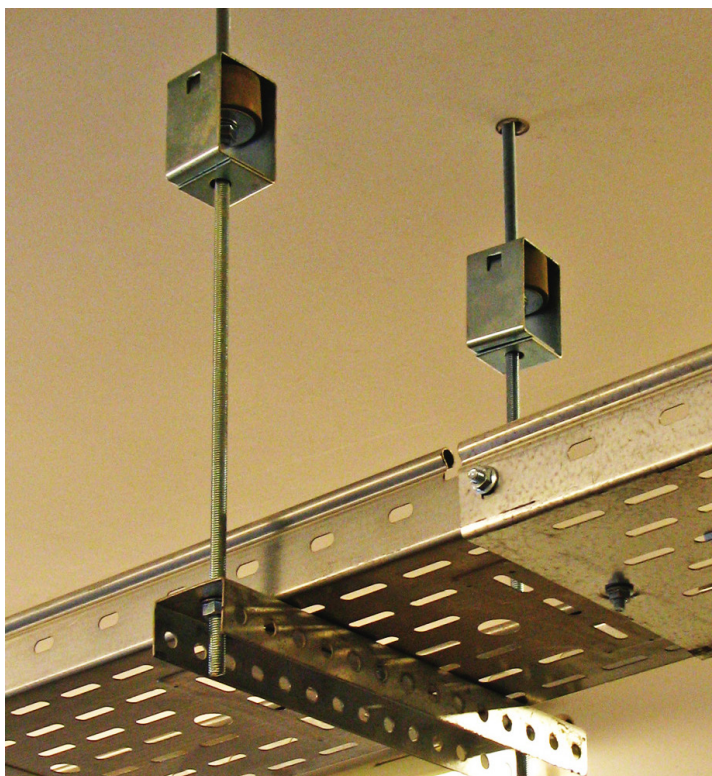
Виброизоляция лотков кабельных сетей
